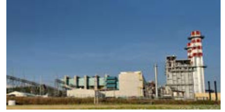
RWE Denizli Santrali, Orta Yoğunluklu Uçak İkaz Lambası, ORGA
