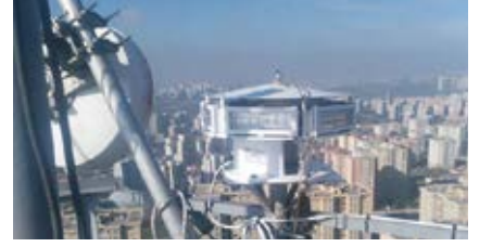
İBB Telekom Kuleleri, Orta Yoğunluklu Uçak İkaz Lambası OBSTA
